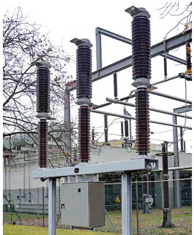
Fig. 4.1-9: 3AP1 FG 145 kV
